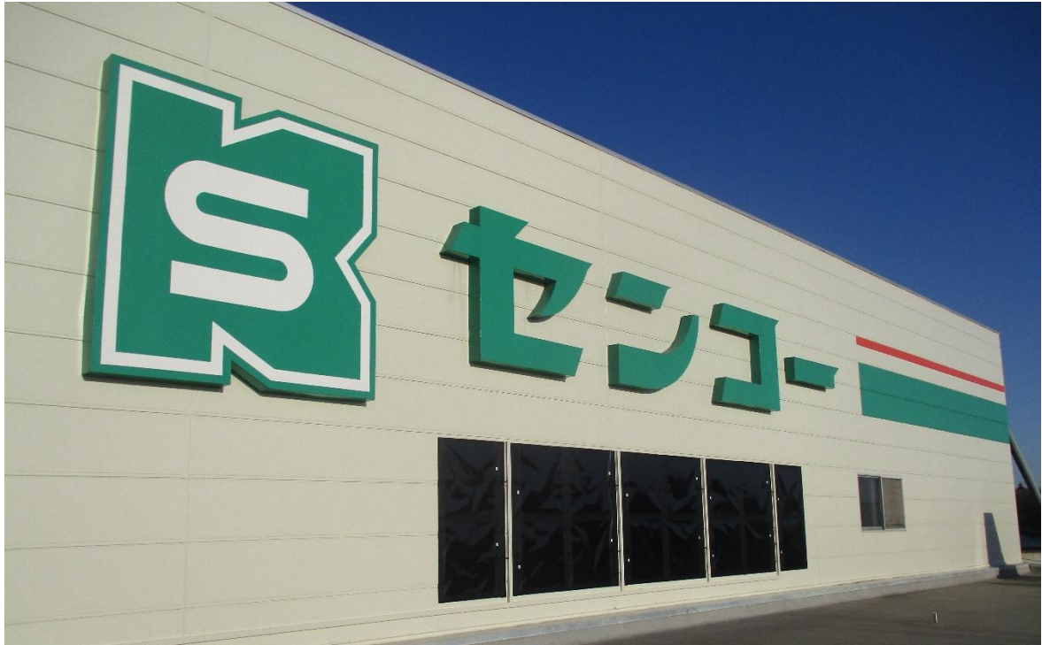
1m×1m のフィルム型ペロブスカイト太陽電池を 16 枚設置
