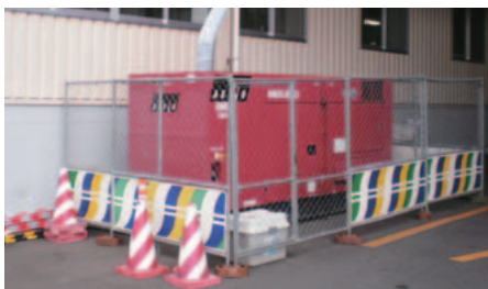
東北地区の物流拠点に設置された自家発電機
