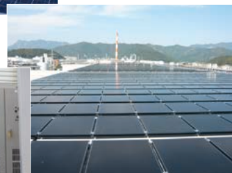
日向PDセンター発電所太陽電池
