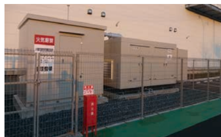
北大阪PDセンターに設置された自家発電機
