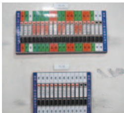
照明エリアを「見える化」したスイッチ
