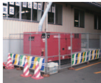
東北地区の物流拠点に設置された自家発電機
